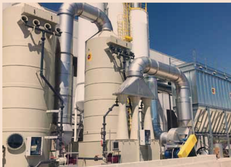
Impianto di abbattimento degli odori tramite scrubbers a letto fisso e venturi, con pre-filtrazione delle polveri
